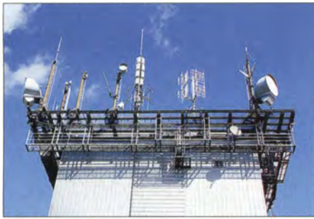
Bild 12: Antennenvielfalt auf der Plattform des Turms
