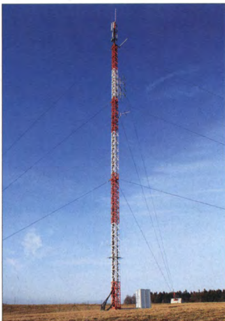
Bild 6: 50 m hoher Antennenträger
