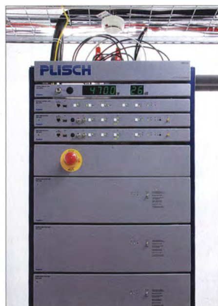
Bild 11: Baugruppen des ersten Senders für DAB+ in Thüringen: Anzeige, Steuerung, zwei Exciter, Leistungsmodul (im Bild nur drei von acht)
